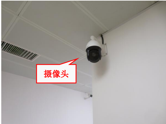
图 3-9 机房内监控设备（一）
