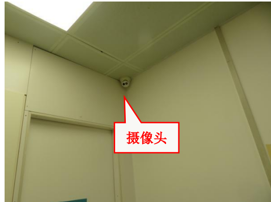
图 3-12 机房内监控设备（四）
