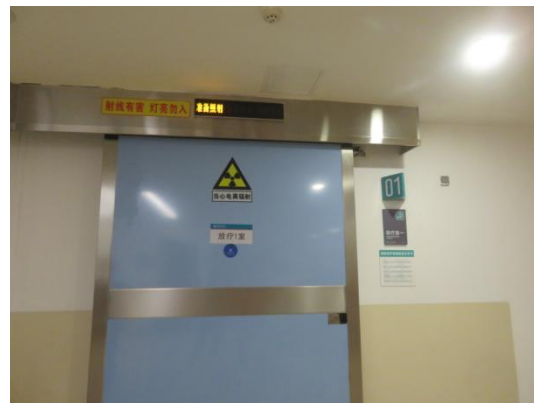
图 3-2 机房防护门（准备照射状态）
