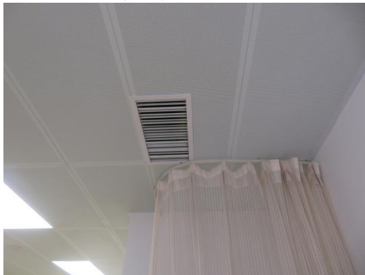
图 3-25 机房吊顶上送风口
