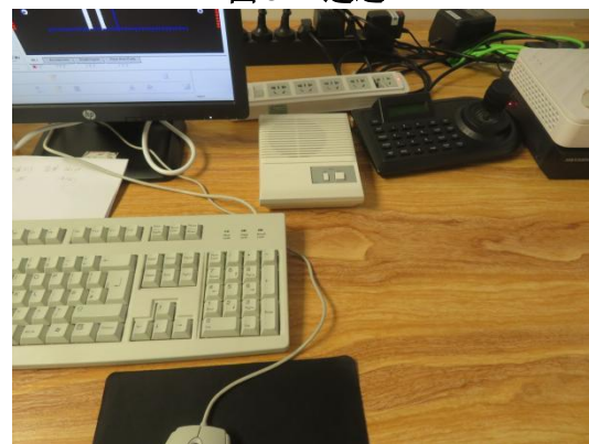
图 3-6 控制室内对讲装置
