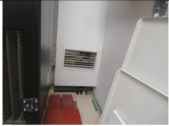
图 3-24 机房内排风口（二）
