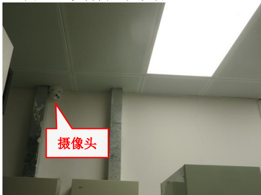
图 3-13 机房内监控设备（五）
