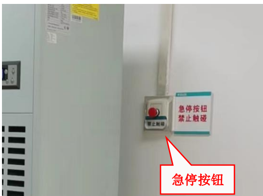
图 3-21 机房北侧墙急停按钮（六）
