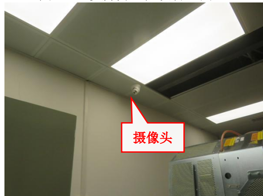
图 3-14 机房内监控设备（六）
