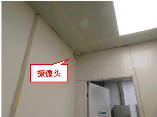
图 3-11 机房内监控设备（三）
