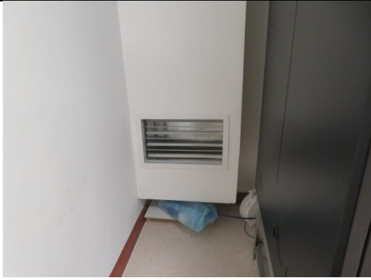
图 3-23 机房内排风口（一）
