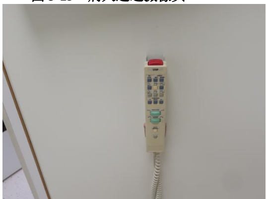
图 3-17 机房内急停按钮（二）
