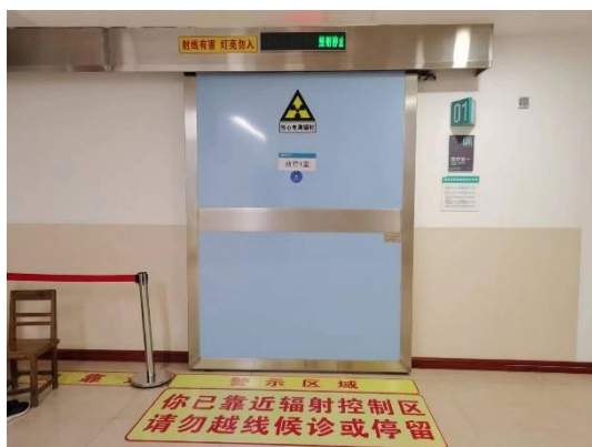
图 3-1 机房防护门（照射停止状态）
