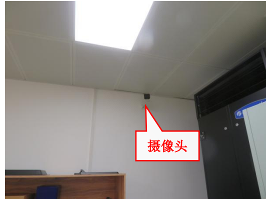
图 3-10 机房内监控设备（二）
